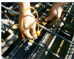
a) sensor embebido no betão
