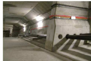
c) caminho de cabos
